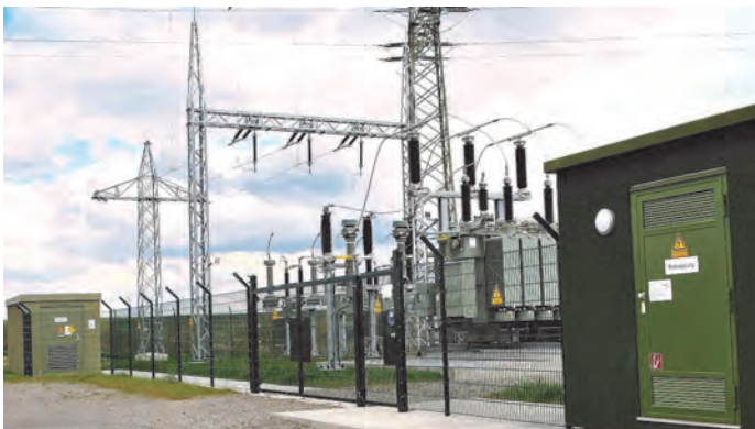
Umspannwerk zwischen Wülfershausen und Eichenhausen (Alte Kreisstraße NES 3)
